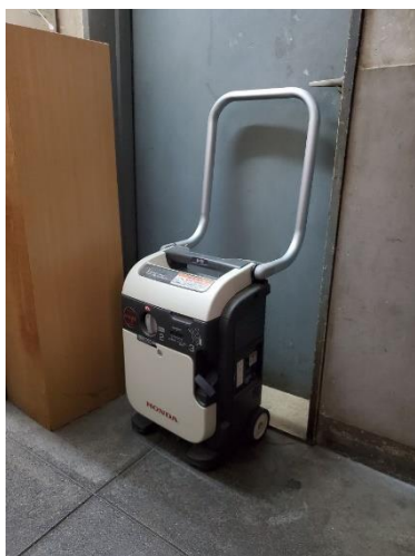
図 | 小型発電機(現役場)
