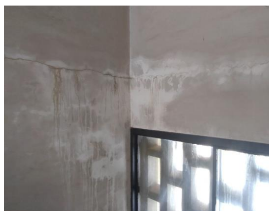
壁のひび割れ現況
