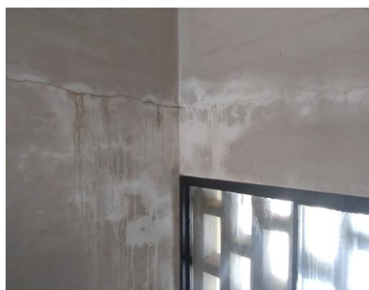
壁のひび割れ現況
