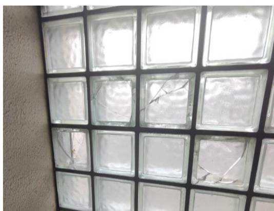
ガラスブロック破損状況
