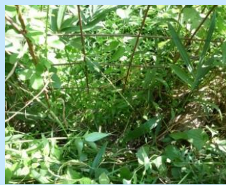
ワイヤーメッシュ柵の下に隙間
